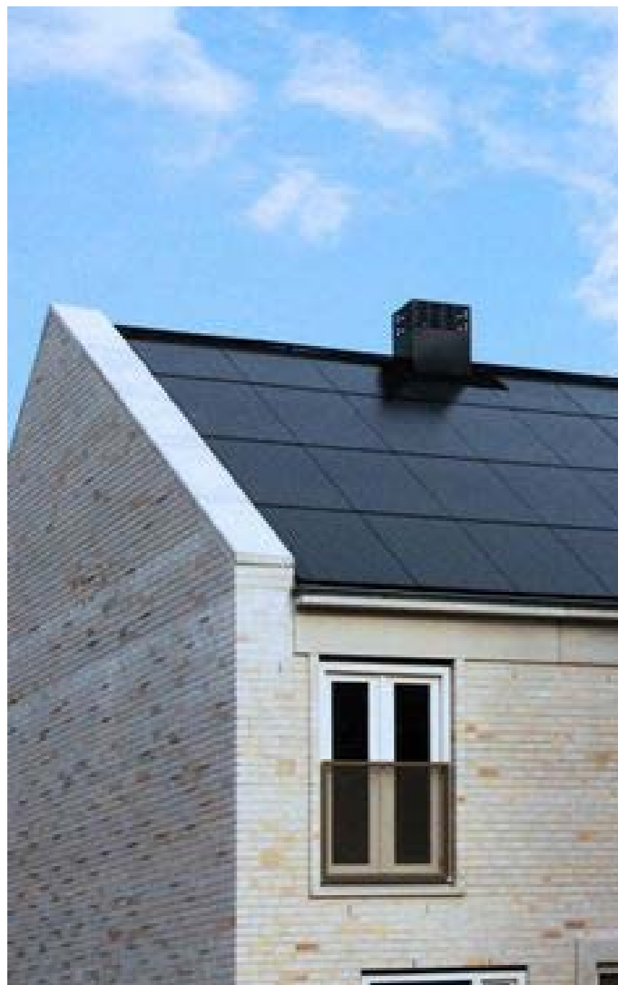
Zonnepanelen op dak als inbouw vlak met dakpannen
