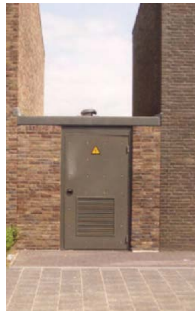
Elektrakastjes geïntegreerd binnen de bouwvolumes
